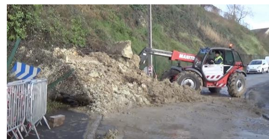
Eboulement rue Emile Zola – 23 janvier 2018
